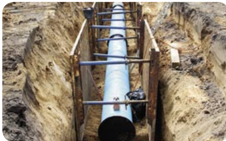
Eine exakte Verlegung ist wichtig für einen störungsfreien Betrieb
