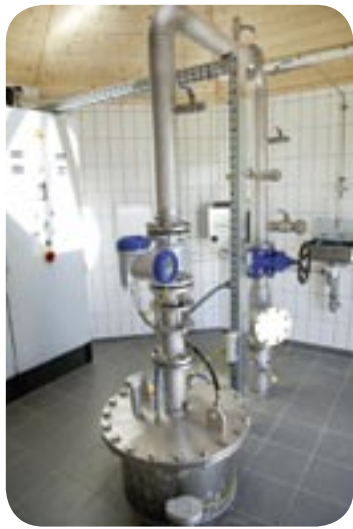
Neueste Technik im "Haus" der Vertikalfilterbrunnen
