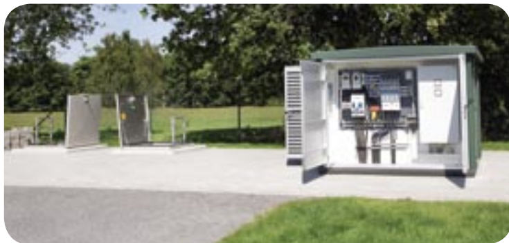
Neuer Rohrreinigungsschacht (links) und Trafostation
