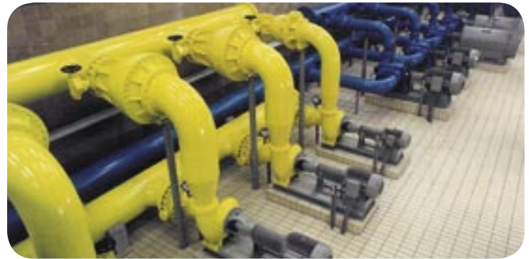
Spül- (gelb) und Reinwasserpumpen (blau) im Wasserwerk Brochterbeck
